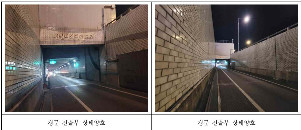
【사진 3.3.36】 갯문 손상현황
