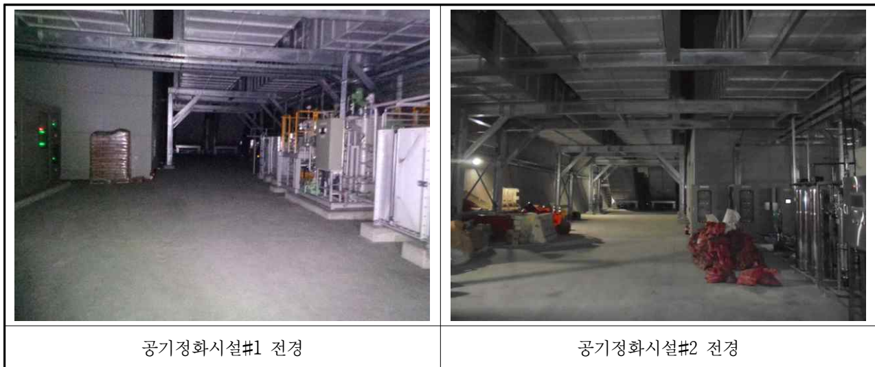
【사진 3.3.39】 공기정화시설 전경
