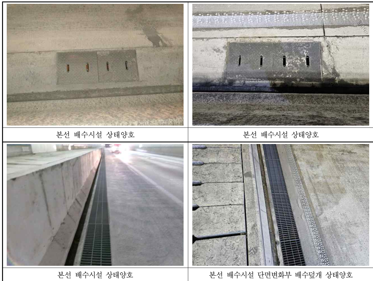
【사진 3.3.16】 배수시설 손상현황
