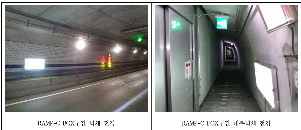
【사진 3.3.22】 BOX구간 벽체 손상현황
