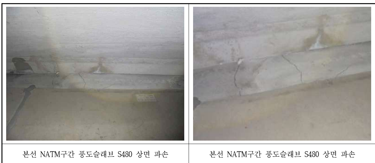
【사진 3.3.10】 NATM구간 풍도슬래브 손상현황
