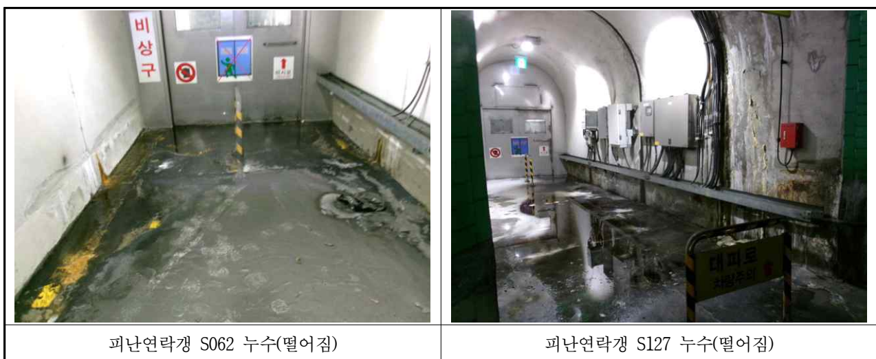
【사진 3.3.38】 피난연락갱 손상현황
