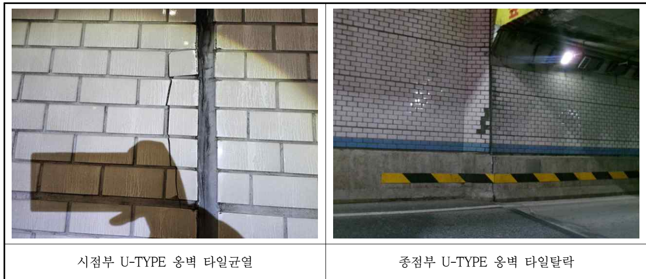
【사진 3.3.42】 U-TYPE 옹벽 손상현황
