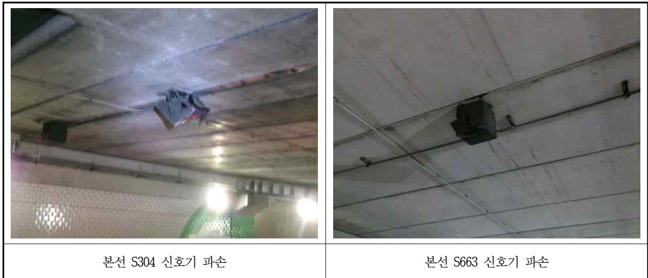
【사진 3.3.46】 기타시설 손상현황
