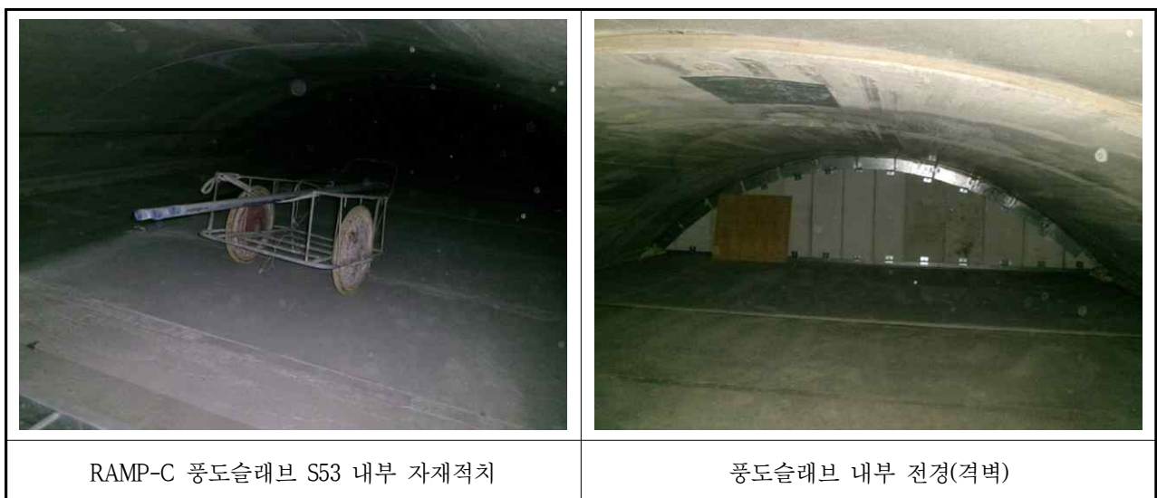
【사진 3.3.28】 NATM구간 풍도슬래브 손상현황
